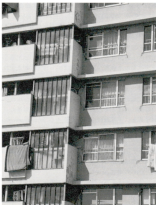
写真4-3 強振動によるマンションの剪断亀裂
