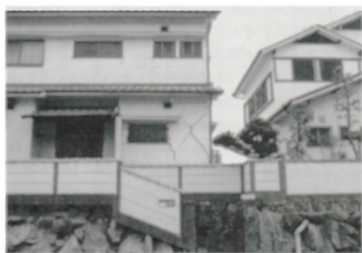
写真2-5 強震動によって剪断割れ目のできた家屋
