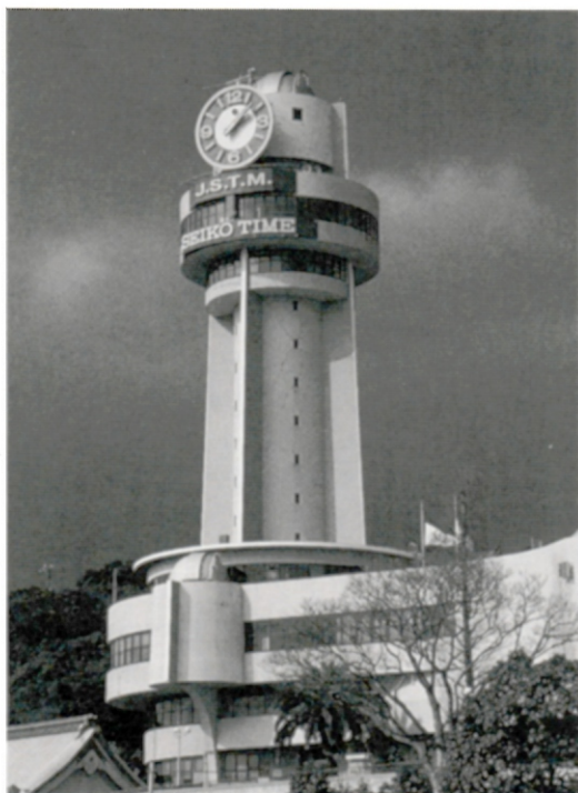
写真4-1 剪断亀裂の発生した明石天文台
