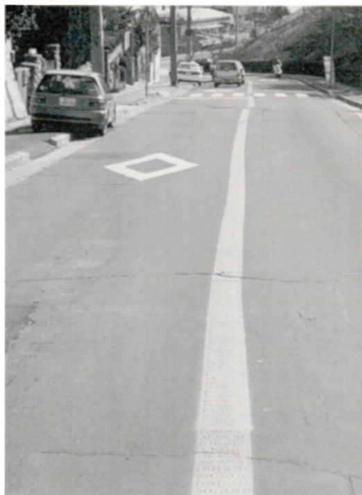
写真4-2 地すべりによる道路の“右横ずれ”
